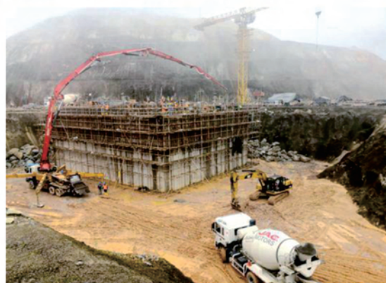
米拉多铜矿废石破碎站
